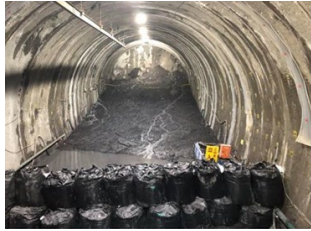
トンネル坑内土砂流入状況
